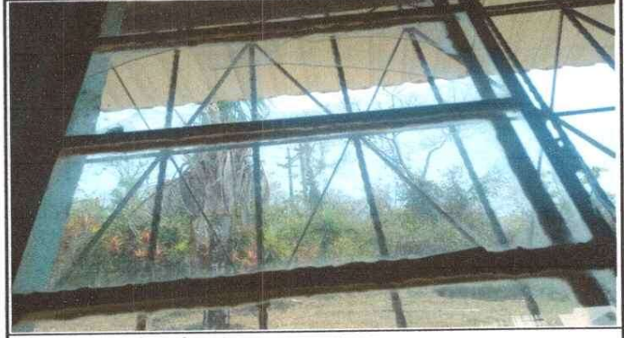
Foto 8: Estado Actual ventana.
