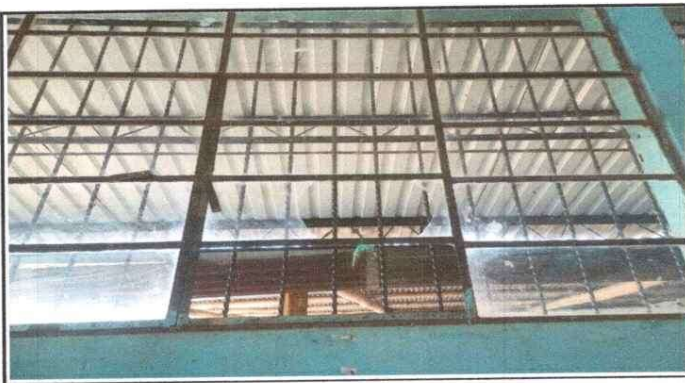
Foto 9: Estado actual ventana.
