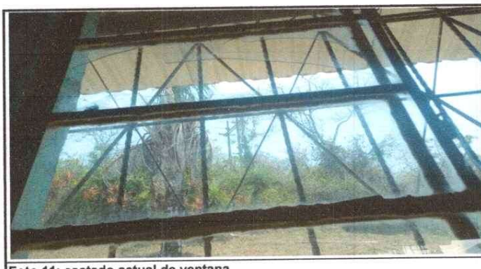
Foto 11: esatado actual de ventana.
