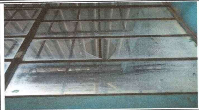
Foto 7: Estado actual ventana.
